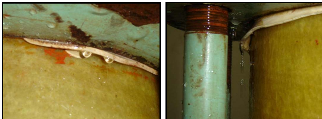
Figura 37: Vazamentos devido ao escorregamento das borrachas de vedação.
